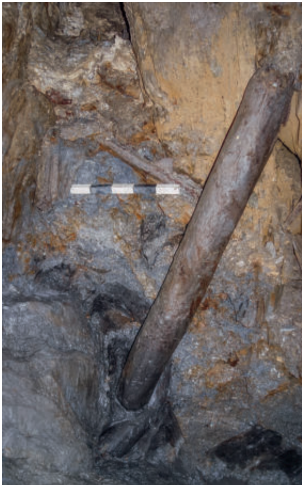
Abb. 88: Dreigliedrige Stempelzimmerung an Fundstelle 4635. Zwischen dem oberen Ende des Stempels und dem Anstehenden befindet sich ein völlig verdrücktes Kopfholz. Das untere Ende liegt auf einem Schwartling oder Rundholz auf (Hölzer nicht detailliert aufgenommen; Blickrichtung: Osten; Länge des Maßstabs: 50 cm; Foto: DBM).
