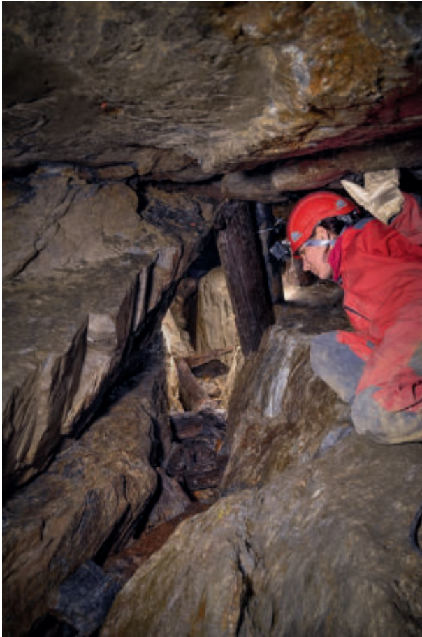
Abb. 37: Verzimmerungen über dem Ansatz der ausgeerzten Gangfuge des westlichen Erzkörpers an Fundstelle 4650 (Blickrichtung: Nordwesten; Foto: DBM).
