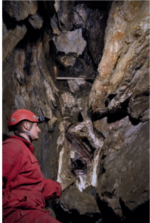
Abb. 38: Verzimmerter und versetzter Hohlraum an Fundstelle 4635. Über dem Versatz ist der Durchstieg zum Hohlraum von Fundstelle 4650 zu erkennen (Blickrichtung: Ost-Südost; Foto: DBM).
