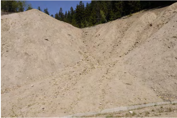
Abb. 113: Situation der sog. „Erosionsrinne“ im Zugangsbereich zum „nördlichen Seitentälchen“ bis 2015 (Foto: Deutsches Bergbau-Museum Bochum/D. Demant).
