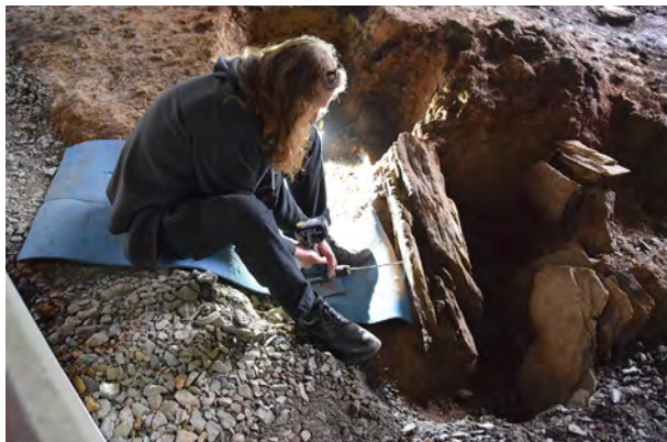
Abb. 194: Th. Lucker setzt Bohrungen für die Einbringung von Edelstahlprofilen (Foto: Restaurierung am Oberbaum).
