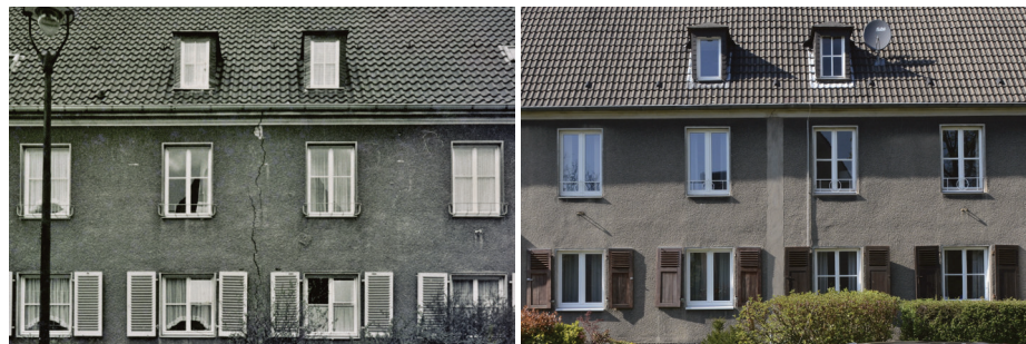
Abbildung 3.8: GLA · BR · 01 Bergschäden am Wohnhaus einer ehemaligen Werkssiedlung. Vermutlich wurde das große Doppelhaus privatisiert, denn es wurden in beiden Haushälften unterschiedliche neue Fenster eingebaut. Das Äußere des Hauses ist im Wesentlichen unverändert, die Bergschaden-Risse wurden jedoch beseitigt. (Quelle: Scharioth und Schräpler 2017)
